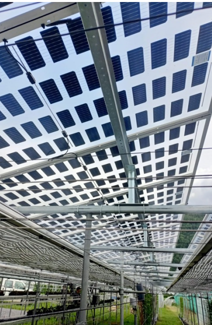
Projet pilote à Conthey par la StartUp Insolight
